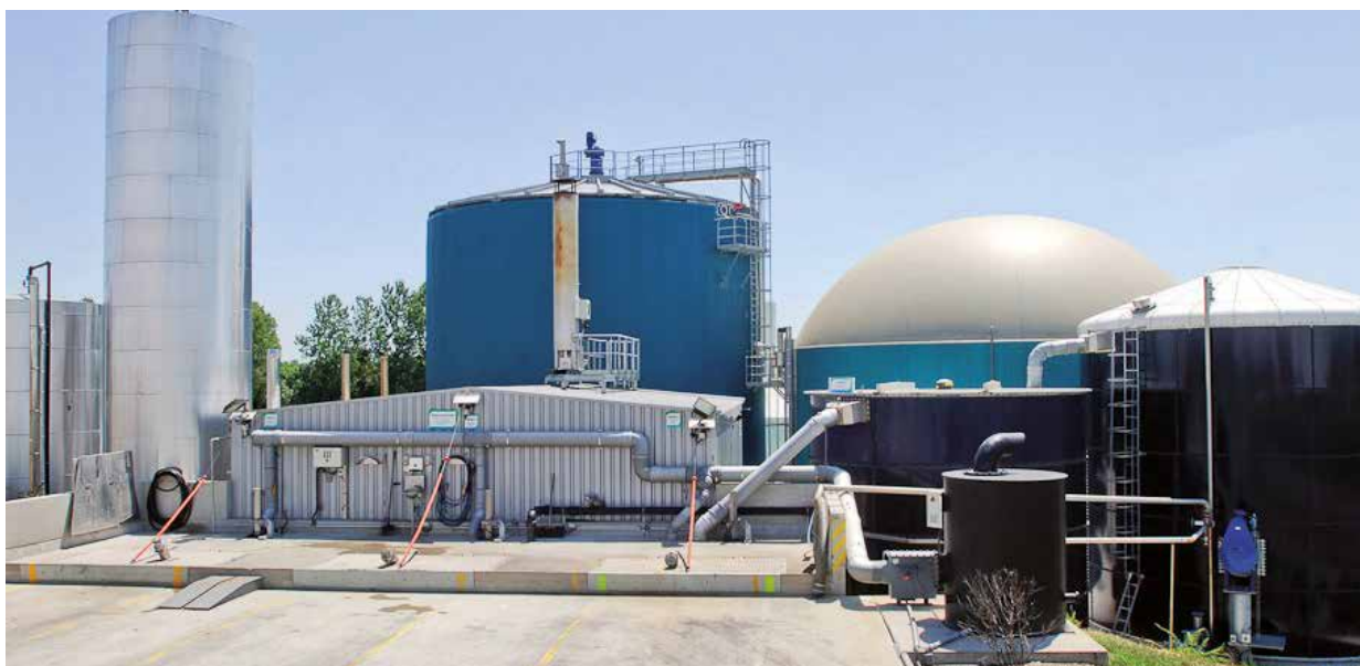
La méthanisation constitue une source d'énergie renouvelable locale et une alternative efficace à l'enfouissement et à l'incinération des biodéchets.
